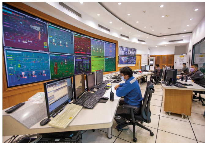
圖為台塑六輕監控鍋爐空污現場，在導入SRF後，台塑被雲林縣要求戴奧辛標準須比焚化爐低，為全台唯一。
